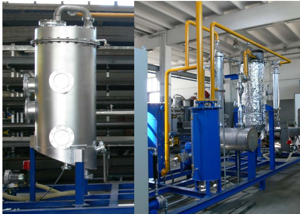
Fig. 3 Impianto pilota 150 kWt gassificatore, sezione di cleaning
